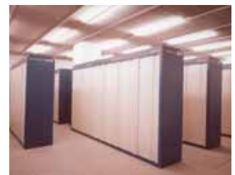
Primera central digital del Sistema 12 que fue instalada en Salamanca. El gran salto adelante en las técnicas de conmutación lo propició la introducción de métodos de "conmutación temporal" hacia la mitad de los años setenta, debido a que los avances en Informática y Microelectrónica proporcionaron las nuevas herramientas que eran necesarias
